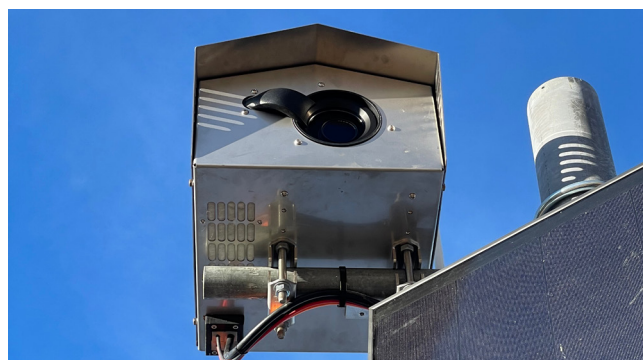
Figure 3 : Caméra avec la souffeuse au niveau de l'objectif et un panneau solaire.
