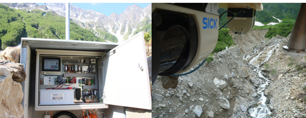
Image de titre : Le ravin de Spreitgraben mesure actuellement plus de 50 m de large pour une profondeur de 30 m.
