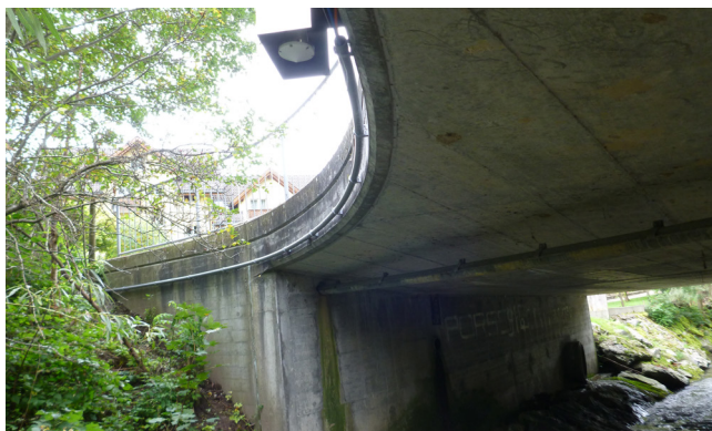
Abbildung 2: Das Radar ist an der Brücke montiert, die Drucksonde im Fluss.
